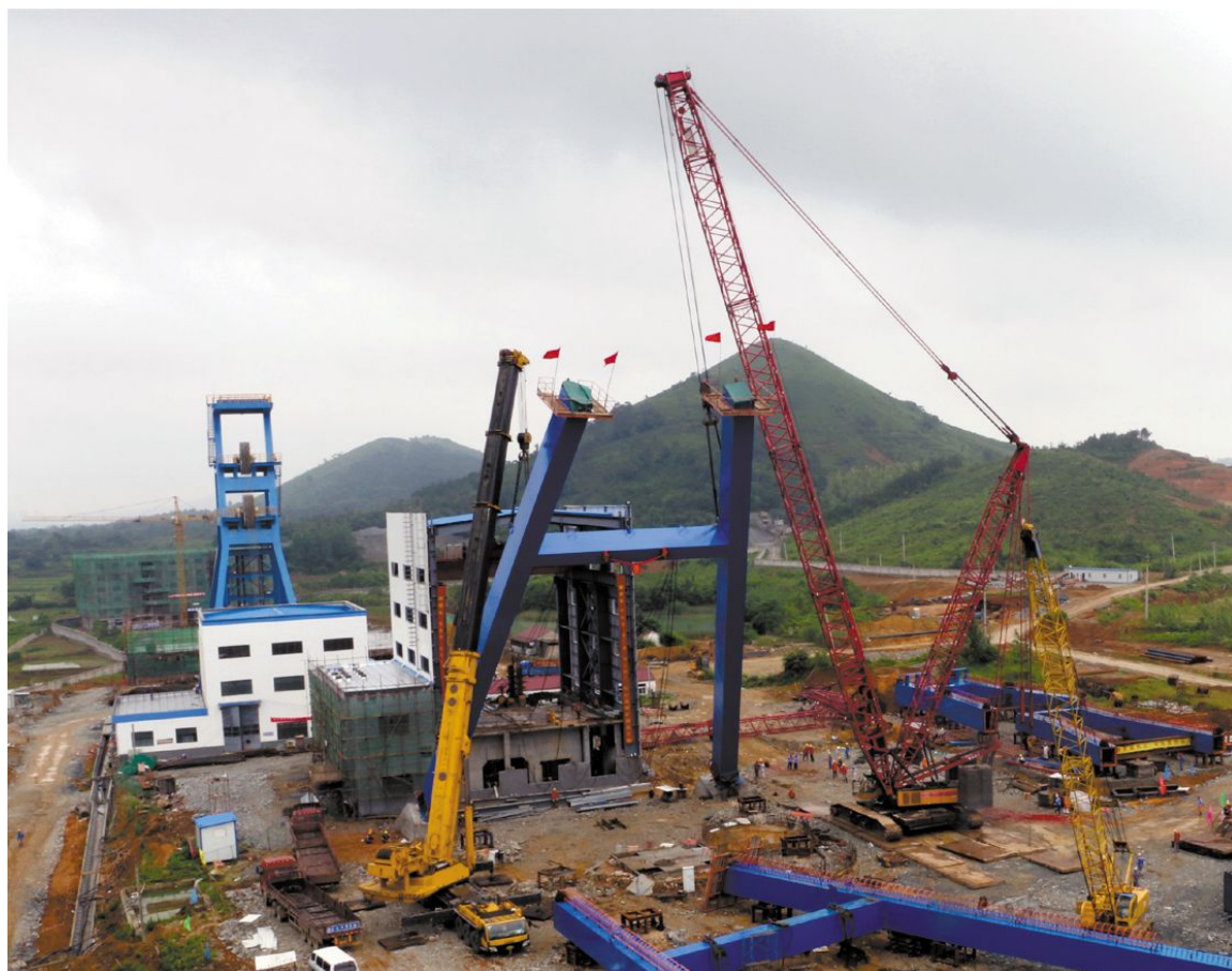
6月12日,铜冠(庐江)矿业公司主井井架开始安装(如图)。据了解,该主井井架为多绳提升钢井架,采用空间框架结构,总高度69.46米,总重量达到920吨,预计50天时间完成所有井架安装工作。王树辰 蒋维海 摄
