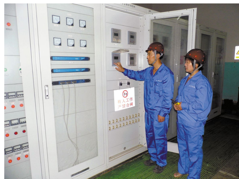
进入夏季以来,仙人桥矿业公司以“增产节支,提质增效”为主线,不断调整工作思路,在设备维护、检修中不断推广节能降耗技术,并严格按照《分时电价管理办法》,从降低能耗、保障设备正常运转入手,低谷用电从过去的33%提高到42%以上。图为6月14日,该公司组织人员对用电负荷进行现场调控。本报记者 江君 通讯员 周钧 摄
