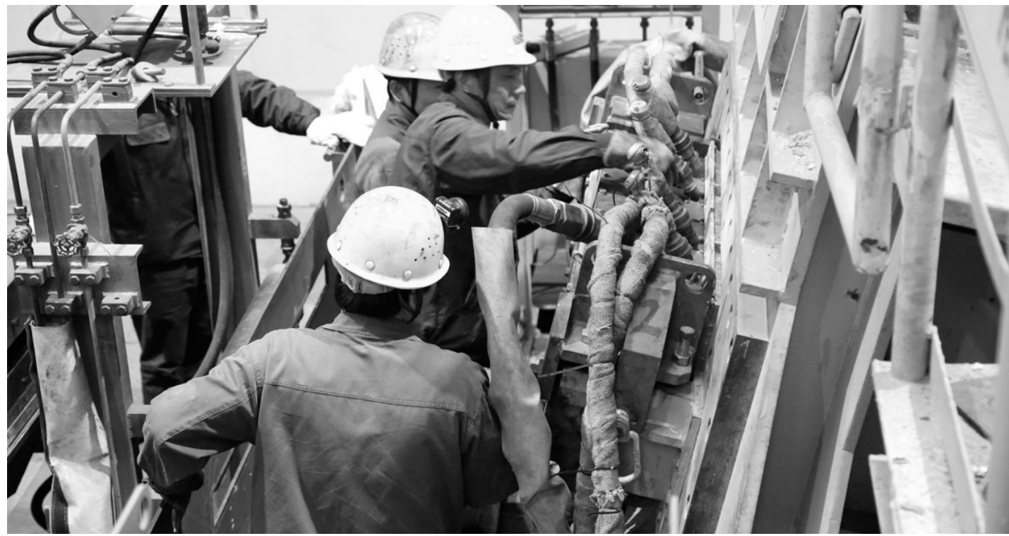
金隆铜业公司职工日前在水平连铸保温炉前安装结晶器。金隆铜业公司水平连铸机组中的结晶器是连铸生产的关键部件,但结晶器在使用到一定期限时就会出现老化磨损现象,为保证水平连铸的质量和稳定,必须及时更换。日前,该公司组织维修技术人员对已出现磨损的结晶器成功地进行了更换。
