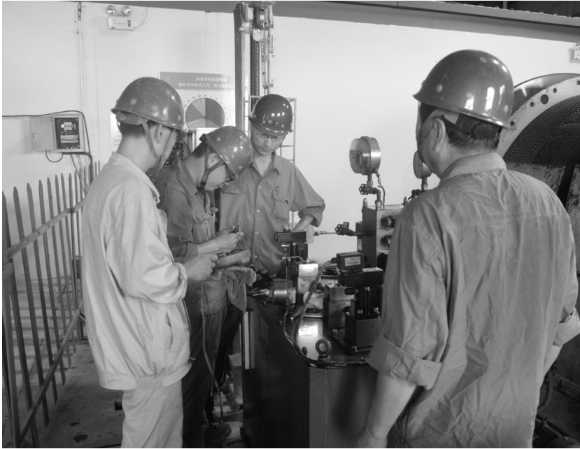
仙人桥矿业公司在主井卷扬机调试时液压站突发故障。该公司员工闻讯后,立刻组织人员连夜加班对液压站进行抢修,确保矿山正常提矿。图为技术人员在液压机工作现场研究。
