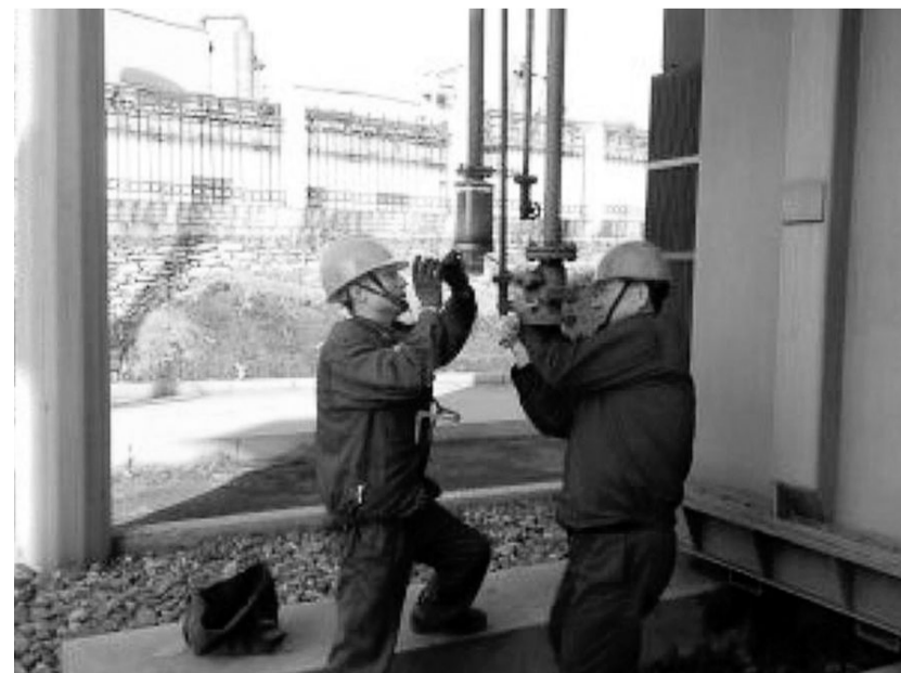
金昌冶炼厂积极组织党员开展“导师带徒”活动,师傅“面对面”、“手把手”向徒弟传授业务技术,通过“干中学,学中干,促使青工不断成长。图为该厂动力车间维修电工赵健与江守军师徒二人正在进行维修作业。齐宏明 许月梅 摄
