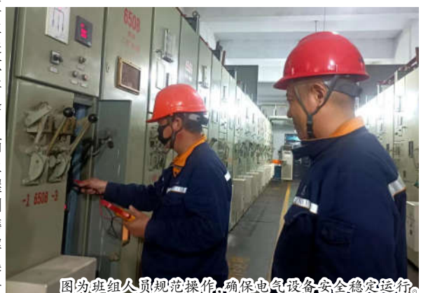
图为班组成员规范操作,确保电气设备安全稳定运行。
