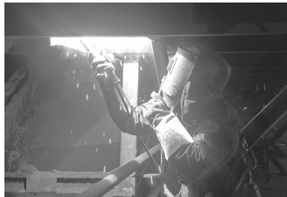
为全面贯彻落实党建会职代会精神,近期,热电厂分厂紧抓设备基础管理不放松。严格落实设备定期点检润滑制度,减少主辅设备波动,以管为主、以修为辅,全员参与设备管理,确保设备安全稳定运行。图为检修人员正在检修锅炉捞渣机。摄影报道 崔丽娜
