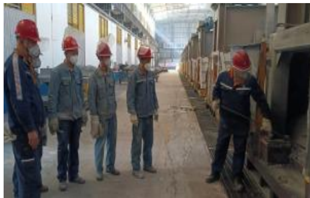
针对近期炭渣打捞质量不高、电解质流失等问题,电解二车间党支部组织党员骨干现场培训炭渣打捞技巧,加强内部沟通交流,对标学习防氧化图层粉刷技巧,通过“双管齐下”,有效地减少了电解质流失,稳定了电解槽情况。图为党员骨干现场培训炭渣打捞。
