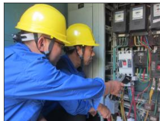
连日来,生活服务中心检修车间针对天气持续高温,居民小区用电负荷大幅攀升的实际,组织人员加强生活区配电室、配电箱等电气设备巡检,及时消除设备隐患,保障小区供电安全。
