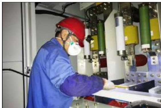
近日,晋铝冶炼电气实验中心充分利用热电分厂6号发电机停机间隙,对全面清扫、检查、试验发电机系统,确保夏季汛期和高温设备安全运行。摄影报道 郭莉 胡方辉
