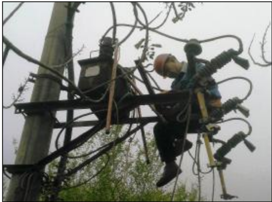
近日,生活服务中心检修车间组织电气工作人员进行系统培训,严格执行《安全工作规程》,对活区电气设备进行全面排查整治,同时加强危险源管理,确保职工群众的安全用电。
