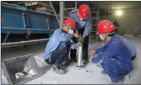
8 月 23 日, 第二氧化铝厂 4300 钢仓下的 1#、2# 料斗秤同时出现卸料门打开超时故障, 计控信息中心二车间自控三班技术人员赶到现场, 处理 PLC 连锁调节, 重新激活恢复 1# 秤正常计量, 拆掉卸料装置部分, 恢复了 1#、2# 正常计量, 保证了生产稳定运行。
