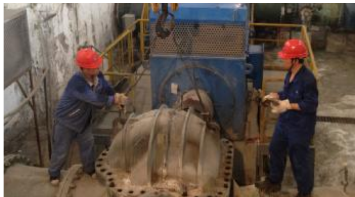
“十一”长假将至,近日,水电分厂二车间对所辖设备开展全面系统的隐患排查,包括水泵、冷却设施、高压开关柜及变压器等设备,并对检查出14项生产隐患进行及时消缺,确保长假期间设备的安全稳定运行。图为5号冷水泵检修现场。摄影报道 薛秋云
