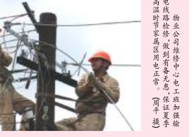
物业公司维修中心电工班加强输电线路检修,做到有备无患,保证夏季高温时节家属区用电正常。(周平摄)
