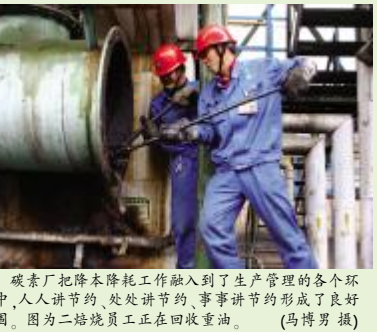
碳素厂把降本降耗工作融入到了生产管理的各个环节中,人人讲节约,处处讲节约,事事讲节约形成了良好氛围。图为二焙烧员工正在回收重油。(马博男摄)
