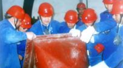
碳素厂检修车间全力以赴抓好回转窑内衬、风管及下料口的施工,为增强生产后劲奠定了坚实的基础。图为近日检修员工对窑下料溜嘴捣打浇注剂做施工准备。(成萍摄)
