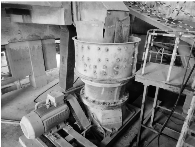
CS440 破碎机捅矿平台改善前。
