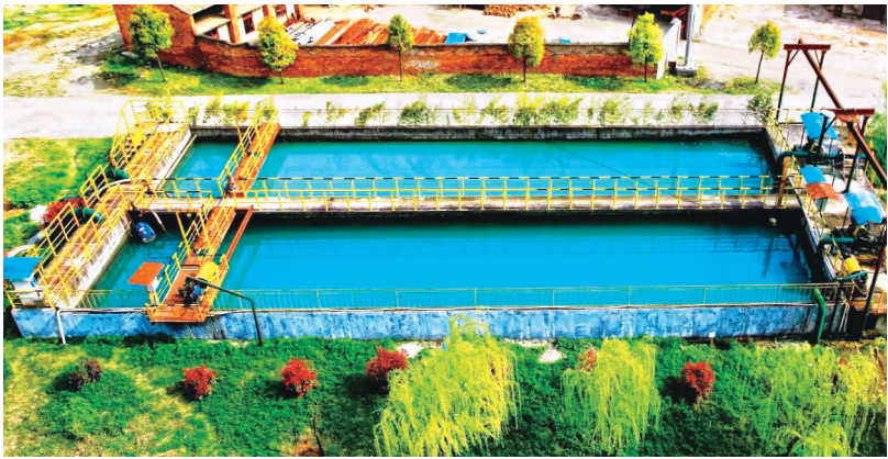
▲千吨废水回收池全景。 刘鑫涛 摄
