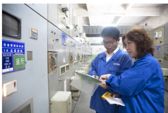
▲5月1日,动力分公司供电车间职工在配电室巡检。王克娇 摄
