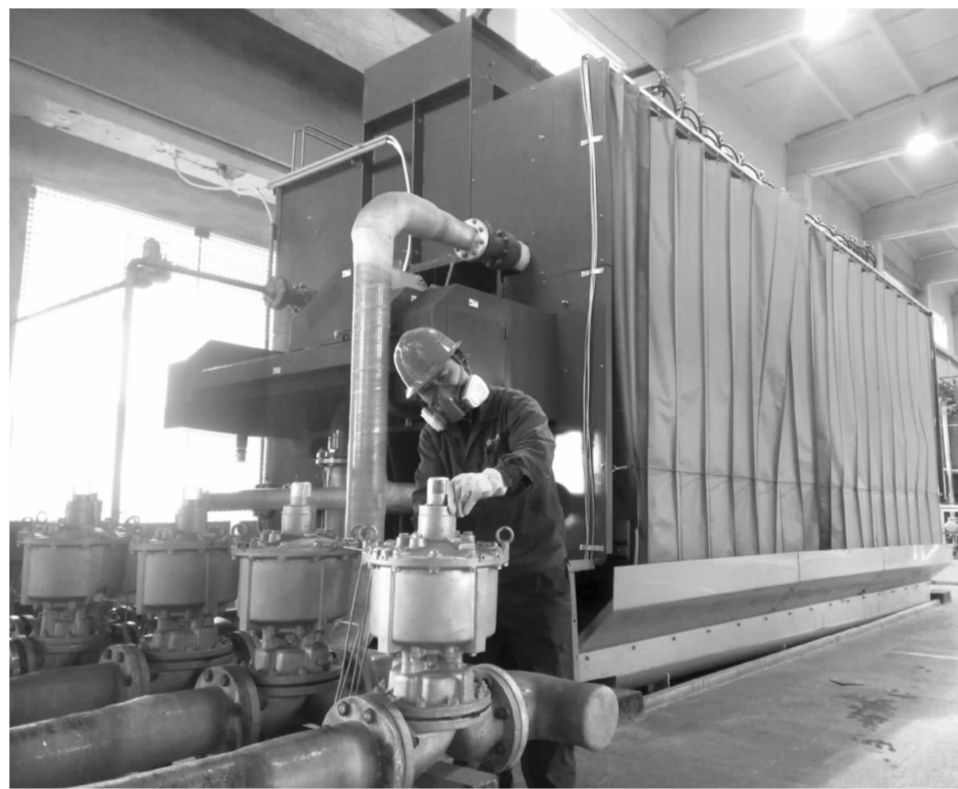
▲粗炼车间职工在观察压滤机运行情况 高功江 摄
