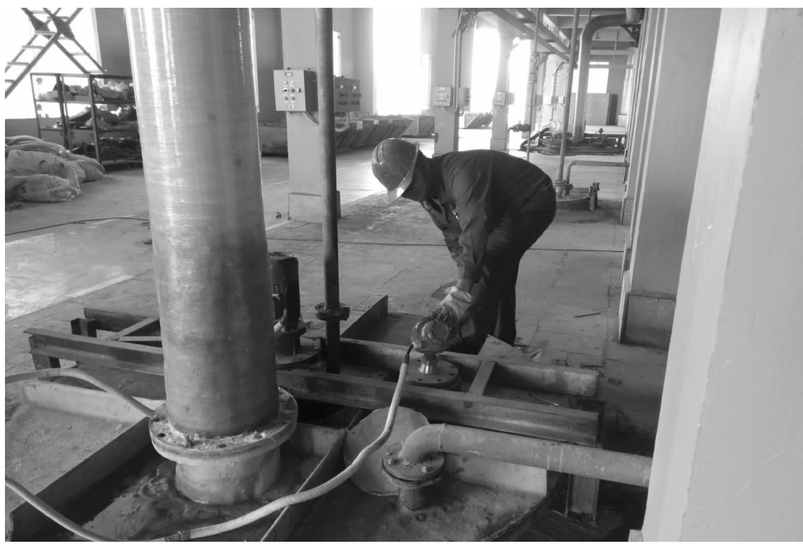
▲图为该车间职工在检查冷凝水槽的液位显示器是否正常。 高功江 摄
