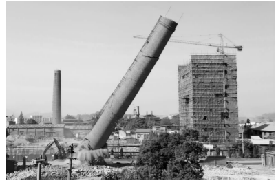
▲10月14日,铜绿山矿选矿车间干燥窑拆除完毕,标志着选矿能改造工程施工自磨系统拆除顺利度过攻坚期。 秦霄 摄
