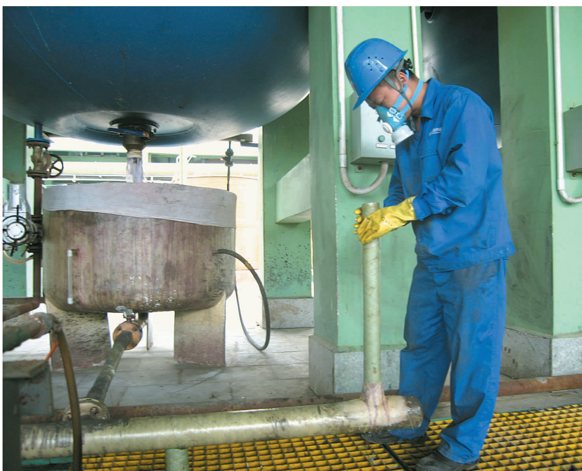
▲图为粗炼车间职工正在检查加装的管道 董小梅 摄
