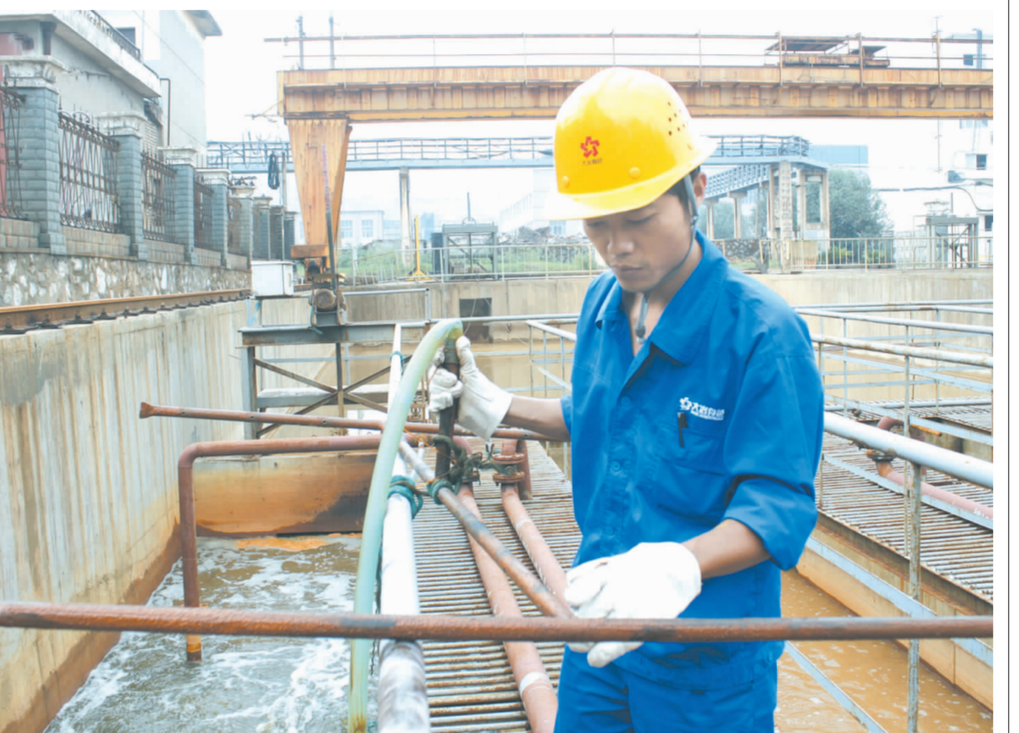
▲图为车间技术人员正在检查曝气管 黄梅梅 摄
