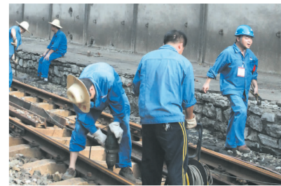
▲8月31日,物流公司工务段进行了20天的奋战完成了厂区九道煤库铁路线的整体大修工作。图为该段职工正在进行最后收尾工作。卫飞 摄
