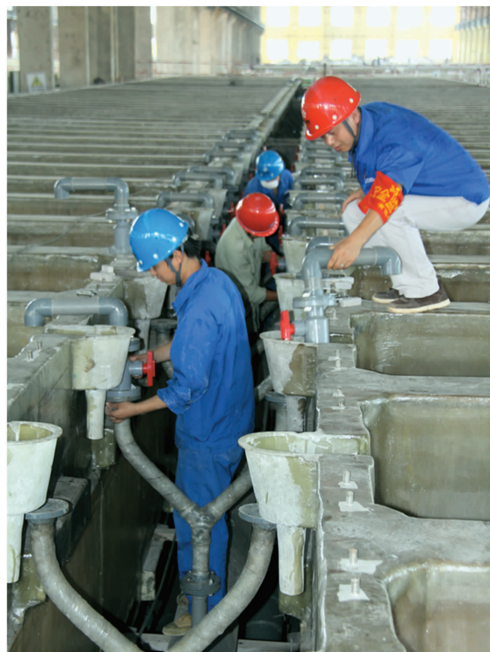
高温酷暑下,建安公司管道技术员“搭把手”,力促30万吨工程建设速度。(程玲 摄)
