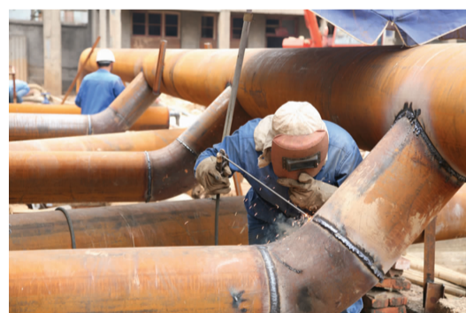
动力分公司在转炉系统节能改造项目中,焊工挥汗如雨地在工作。(张杜文 克娇 摄)
