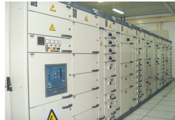
机电公司主打产品——高级型低压抽压柜。(罗纪庚 摄)
