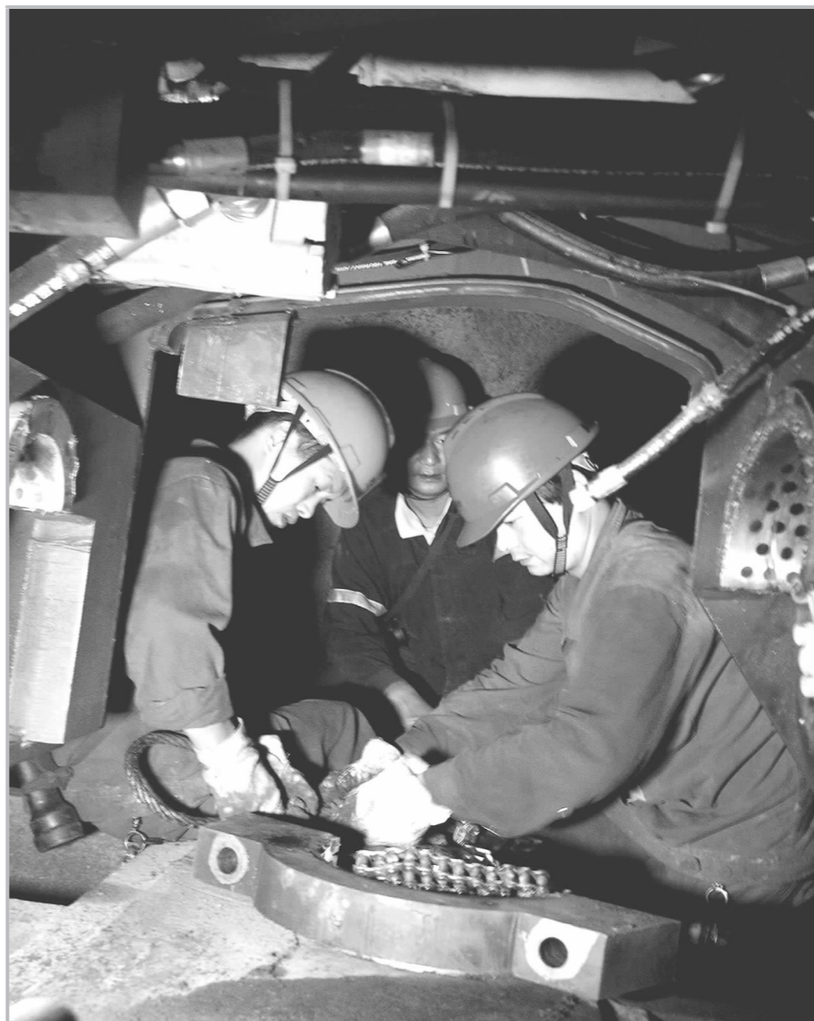
铜绿山矿坑采车间坚持生产靠设备的理念,在加强设备日常管理、着力提高设备管理水平的同时,积极引进新设备、新技术,不断提高装备水平。图为10月16日,该车间设备管理人员在井下组装机新式衡阳DYC-2铲运机。(高元兵 摄)
