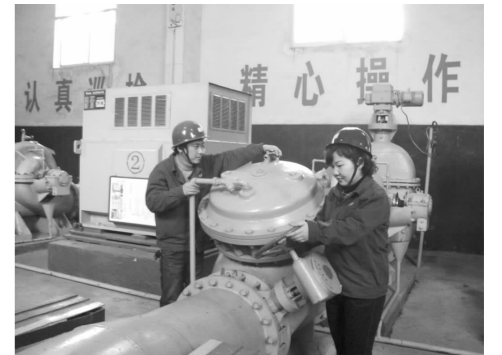
动力分公司供水一车间在“百日安全无事故”竞赛活动中积极组织运行值班人员学规程、用规程、赛规程,以“反三违、查隐患”促进现场安全管理。图为10月23日,该车间二泵班运行人员正在进行2号供水机组的操作演练。(邱华宁 摄)
