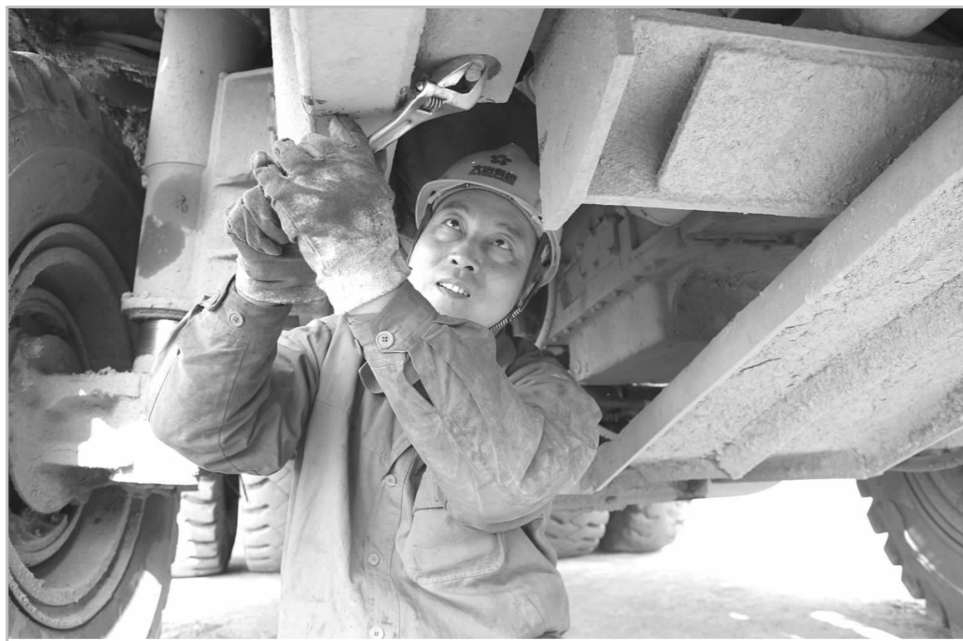
近日,铜绿山矿露天车间对所有生产设备进行了一次全面检查,并安排实施了38个检修项目,为保证设备安全高效运转和全年生产指标的顺利完成打下了坚实的基础。图为9月27日,该车间维修人员正在对矿车底盘进行技术改造。(陈登峰 摄)
