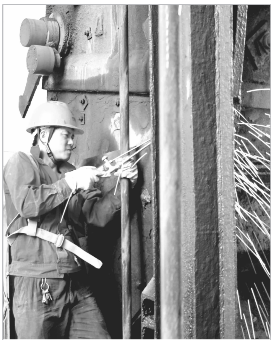
铜绿山矿坑采车间新主井主要承担将井下矿石提升到地面的任务,其安全运行时间直接决定着该车间年产量,为确保完成年107万吨矿石提升任务,该车间机运工段狠抓设备日常点巡检,认真做好设备计划性检修和突击性抢修,有效保证了主井提升系统安全高效运行。图为9月14日,该工段检修人员正在抢修主井箕斗。(高元兵 摄)
