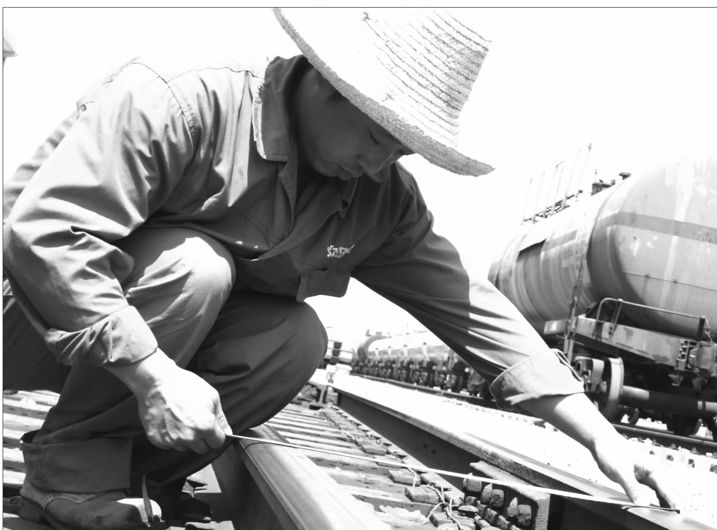
自澳炉铁路专用线投入运行以来,物流公司工务段千方百计做好澳炉专用线的维护保养工作,加大对澳炉专用线的巡查巡检力度,以确保澳炉专用线安全畅通。图为8月22日,物流公司工务段养路工正在对澳炉专用铁路进行轨距测量。(孙媛 摄)
