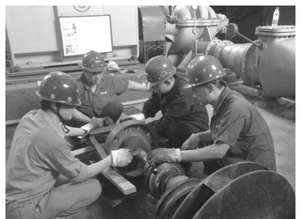
7月26日,动力分公司供水一车间二泵班职工在设备点巡检时发现2号备用清水泵机械密封环处漏水,该车间立即组织抢修,及时排除了故障。
