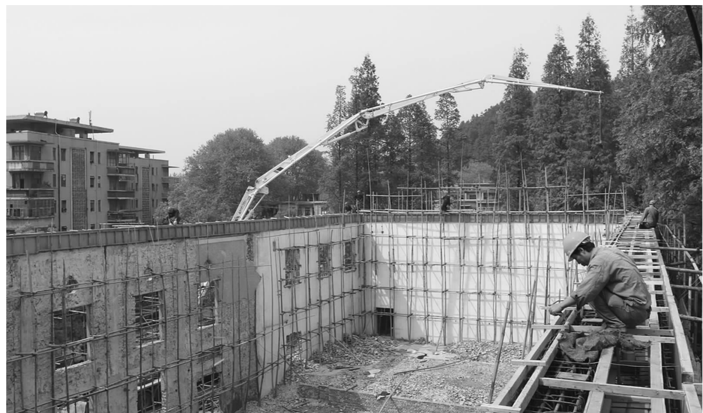
为丰富矿山职工文体活动,今年铜山口矿投资250多万元将上世纪80年代投入使用的俱乐部一楼改造成羽毛球、篮球综合球场,二楼改造成职工健身中心,工程已于2月下旬动工,将于6月份完工。图为承建单位职工正在加紧施工。(童言 摄)
