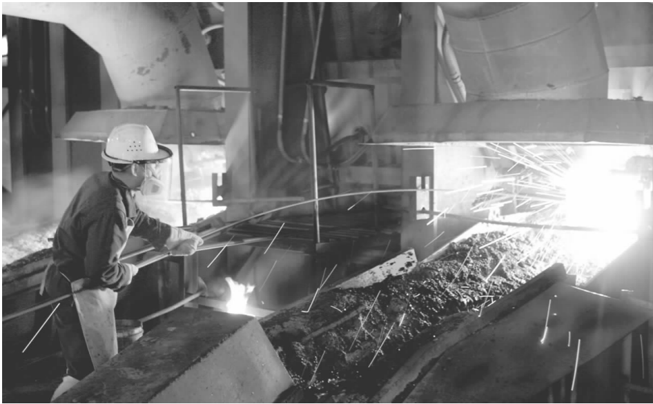
进入四月份以来,冶炼厂不断优化生产工艺,为完成全年生产任务打下良好基础。图为 4 月 11 日,该厂熔炼车间职工正在放渣作业。(刘飞 摄)
