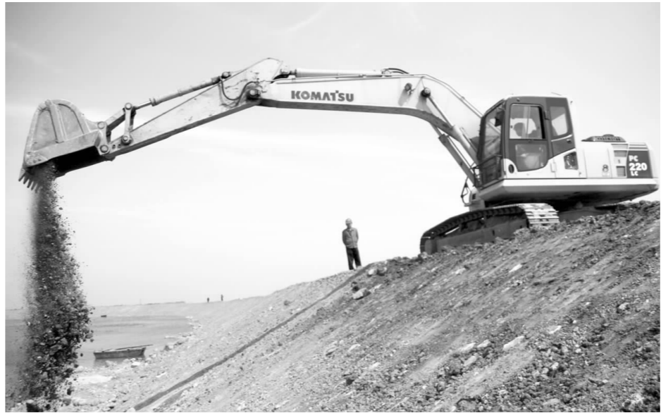
经过一年半的紧张施工,铜绿山矿尾矿库四期一级子坝加高扩容工程已完成抛石挤淤及丁字坝修筑约 47 万立方米,加高土石量约 10 万立方米,坝高已达 37 米。(陈登峰 摄)
