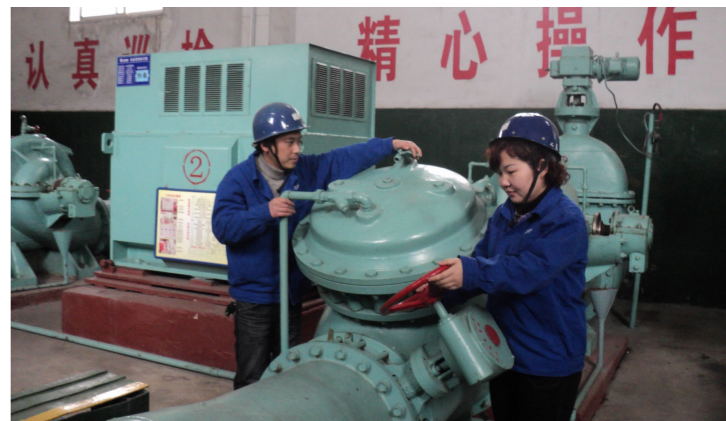
动力分公司供水一车间全体职工认真落实公司和动力分公司两级工作会精神，确保安全生产。图为2月22日，该车间二班职工在精心操作水泵阀门。(黄国荣 摄)
