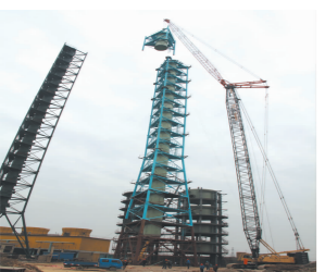
由建安承建的集团公司海拔最高的钢制烟囱塔架于1月13日“平稳入座”。
