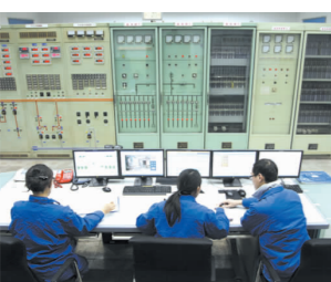
动力厂职工正在精心监控设备,确保电力供应正常。
