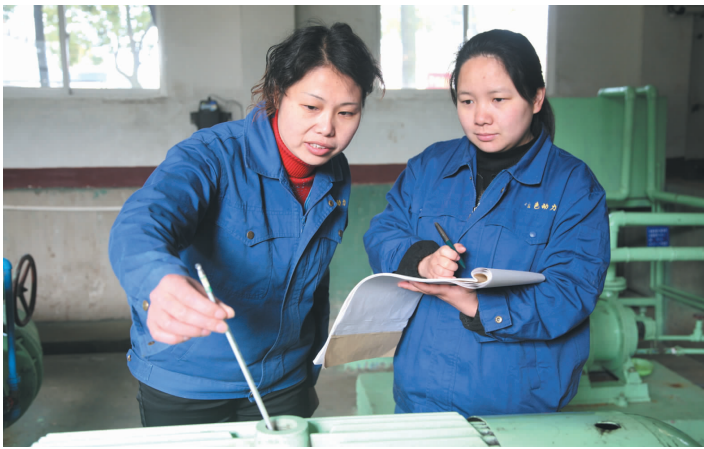
国庆长假,动力分公司各单位提前安排,周密策划,保障两节期间水、电、通讯畅通。图为职工在认真巡检设备运行情况。(王克娇 摄)
