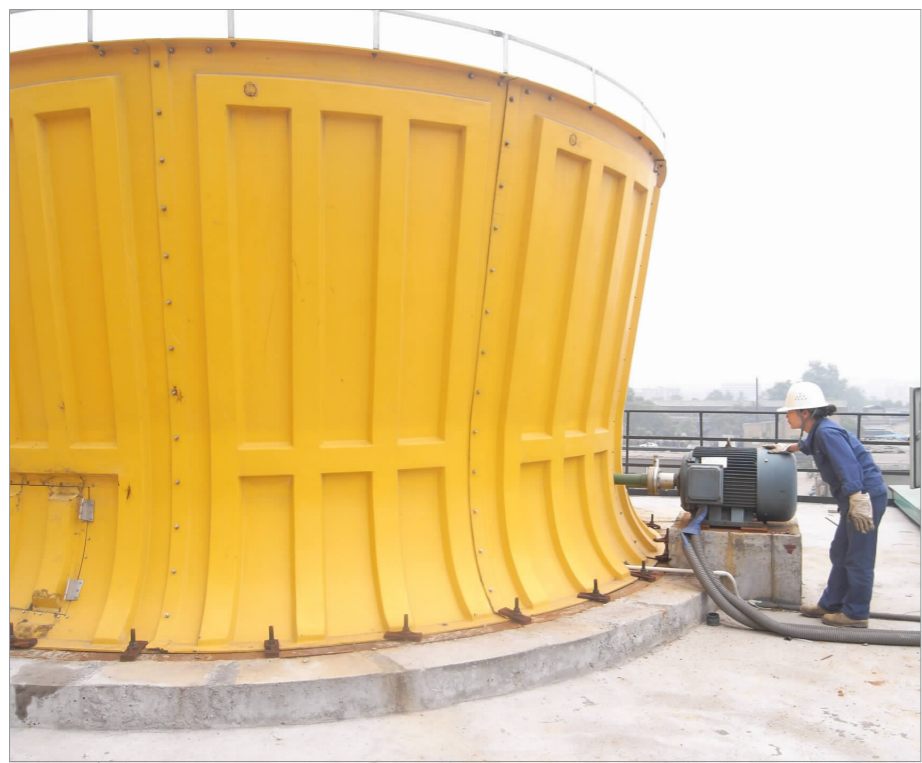
9月15日,冶炼厂转炉车间职工正在对新冷却水塔进行点、巡、检,这是公司重点节能减排工程澳斯特炉配套项目中的循环冷却水系统的部分设施,目前正处于试运行状态。(胡敏 摄)
