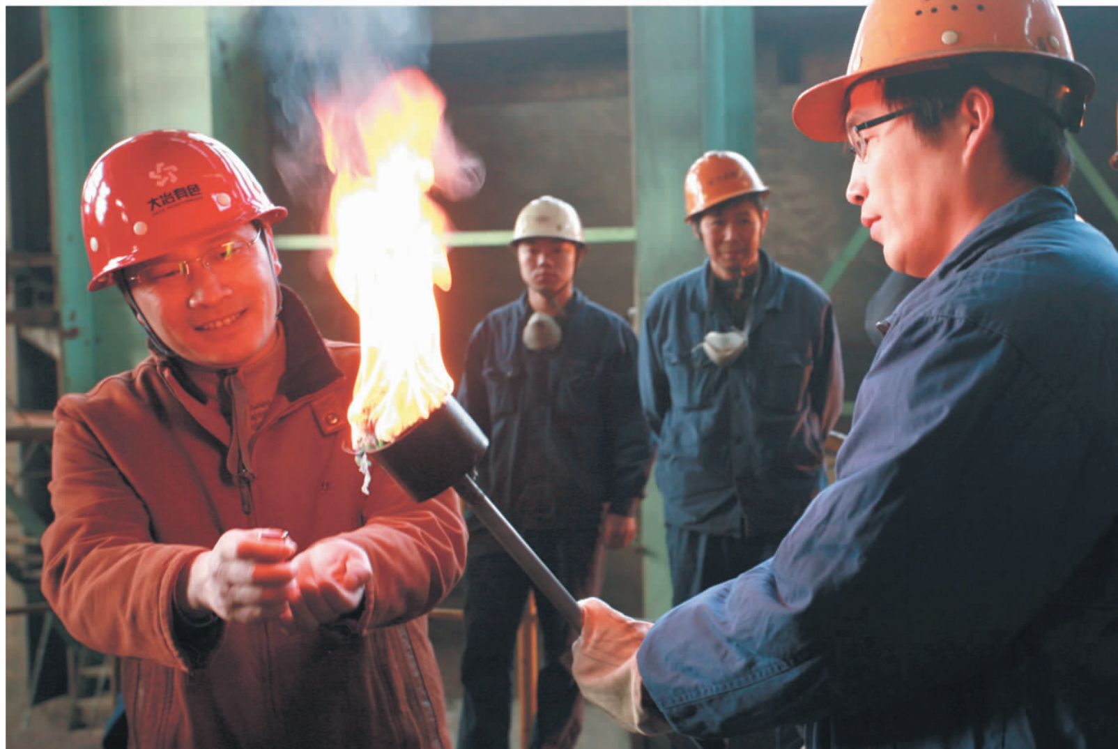
1月26日,冶炼厂为诺兰达炉点火升温,标志着冶化新系统第十一次检修顺利完成,并开始了该炉2010年新一轮的生产。(刘飞 摄)
