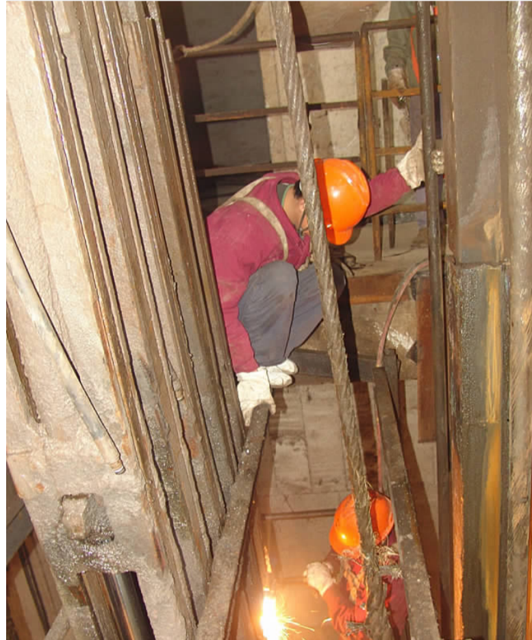
12月14日,铜绿山矿坑采车间机运工段利用主井提升系统相对空闲的时间段,快速完成主井提升箕斗首绳和导向轮衬套的更换,为后期的生产组织减轻了压力。图为职工正在更换主井提升箕斗首绳。(高元兵 摄)
