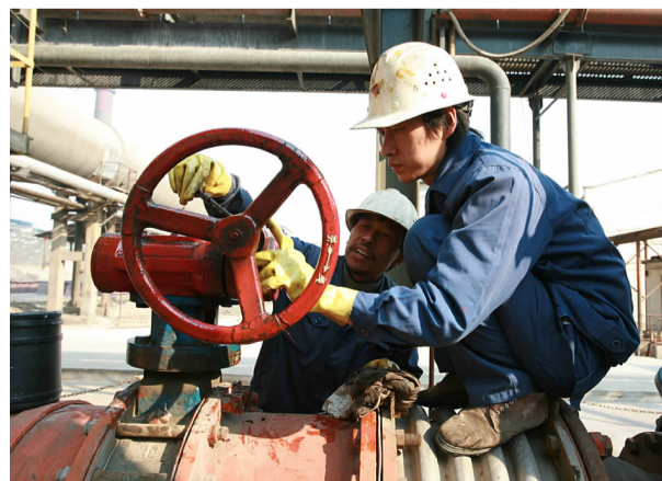
临近年终,冶炼厂重点加强生产关键装置、要害部位的管理,从强化设备基础管理入手,对所有设备进行全面检查维护保养,不让一台设备“带病”运转。图为冶炼厂硫酸车间职工正在保养硫酸四系管道阀门。(刘飞 摄)
