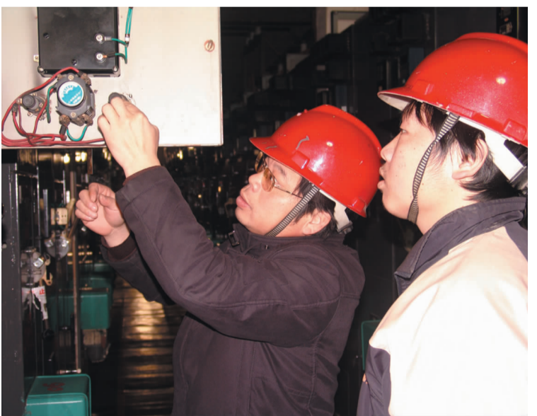
丰山铜业公司坚持班组日检、工段周检、车间月检、公司季检和季节性、专业性、节假日及各战线的安全检查制度。通过检查,消除了生产过程中的危险因素和管理上的漏洞,加大了反“三违”力度,促进了现场安全管理。图为该公司水电车间员工正在进行班组日检。(何永进 摄)
