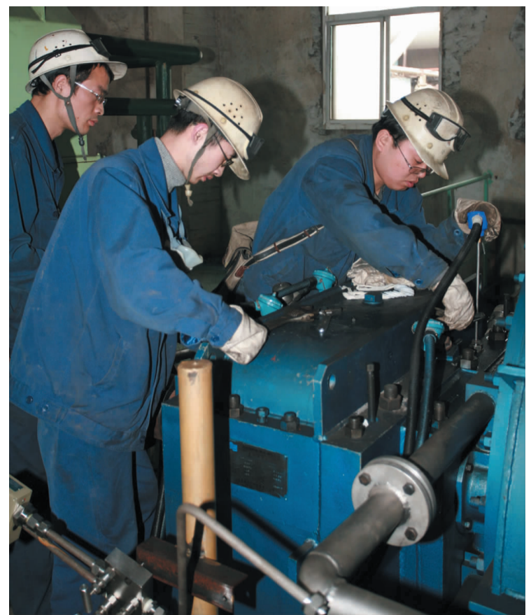
3月11日,在沈阳鼓风机厂专家的指导下,冶炼厂工程技术人员正在调试刚刚安装完毕的2100KW高压鼓风机。新鼓风机具有稳定性好、操作系统先进、节能效果明显等优点。(刘元进 摄)
