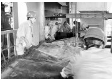
近日,氧化铝一厂八车间组织员工更换了3号悬浮炉皮带,为全面复产做好了准备。 王丽娜 摄影报道
