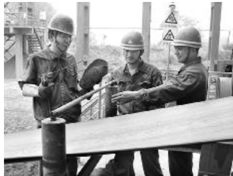
水电厂原料车间磨房工段在建设“党员先锋岗”活动中,结合岗位特点,不断创新创优。以小改小革、降本增效为基础,扎实开展创建活动。图为车间党员正在对长达270米的皮带制作描线架并安装皮带托辊,解决了皮带跑偏后加剧磨损的问题。
