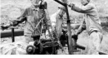
8月5日,针对热电厂渗水回收系统故障导致坝顶溢流,影响当地居民正常生活这一问题,热力厂检修车间组织技术人员对渗水回收系统进行了检修。图为检修现场。
