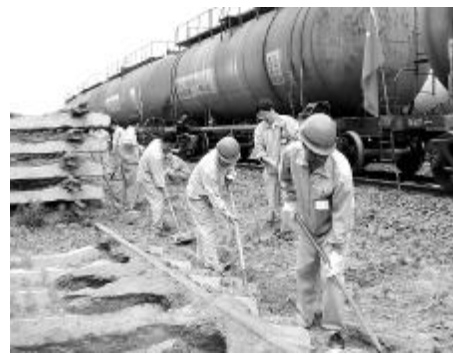
近日,运输部领导带领二百余名党员,在专用线作业站16道和17道二股道线间掘开了一条引水渠,为汛期排水畅通打下了坚实的基础。因为党员在鲜红的党旗下义务劳动。 欧阳建阳 摄影报道
