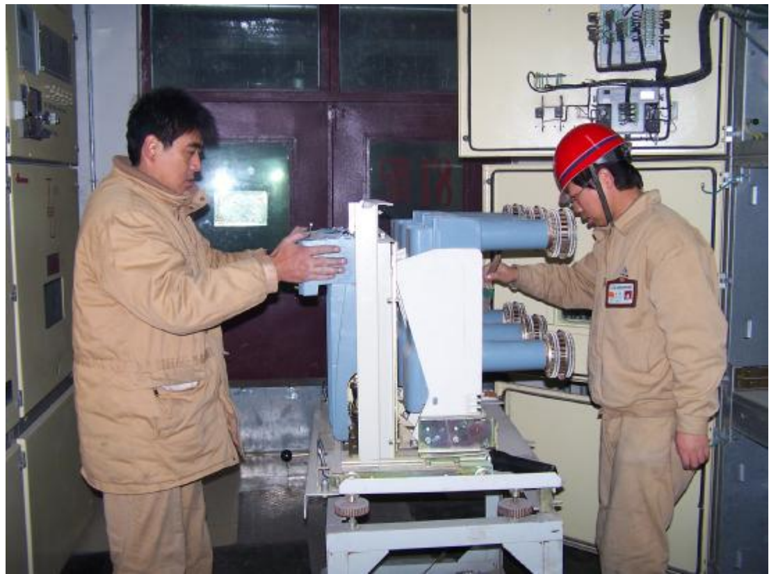
为保障设备安全正常运行,自备电厂电气车间组织员工对重要设备进行了维护和保养。图为员工正在润滑、清扫设备。
