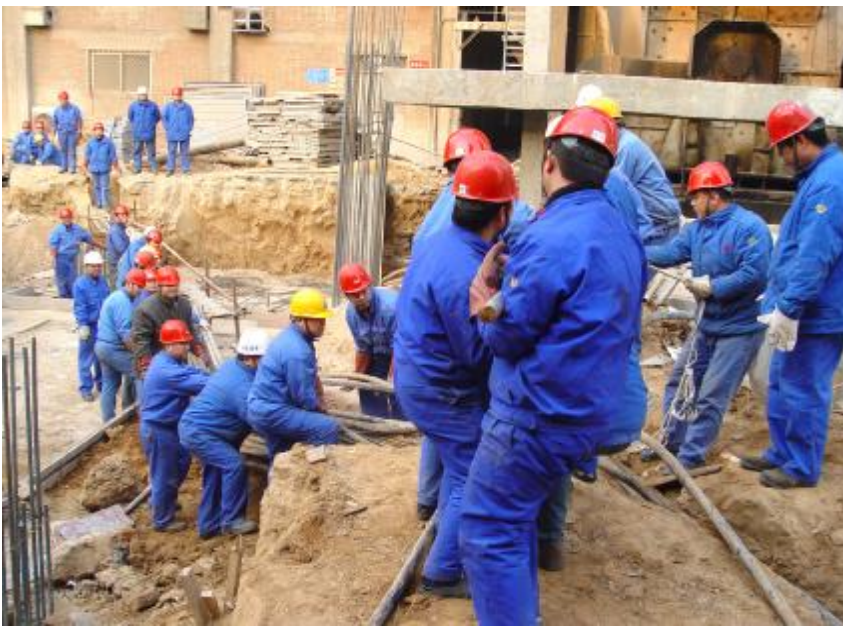
近日,水泥厂党委组织党员到低温余热项目现场转移电缆。50多名党员进入狭小的电缆沟内拆除固定电缆的数百个固定带,理顺了40多根凌乱的电缆。经过3个多小时的劳动,他们共拉大小电缆70多根,比计划提前1个小时完成了任务。图为拉电缆现场。王玉焕 摄影报道
