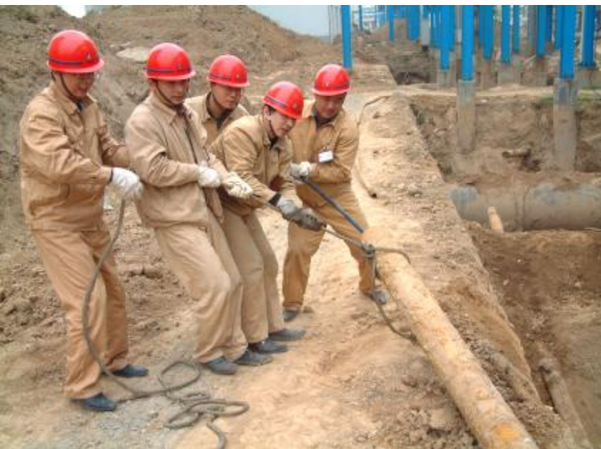
近日,自备电厂检修车间党支部组织车间党员开展了义务劳动。图为党员在起吊废弃管道。经济理测试后,合格的管道会重新被利用。冯惠武 摄影报道
