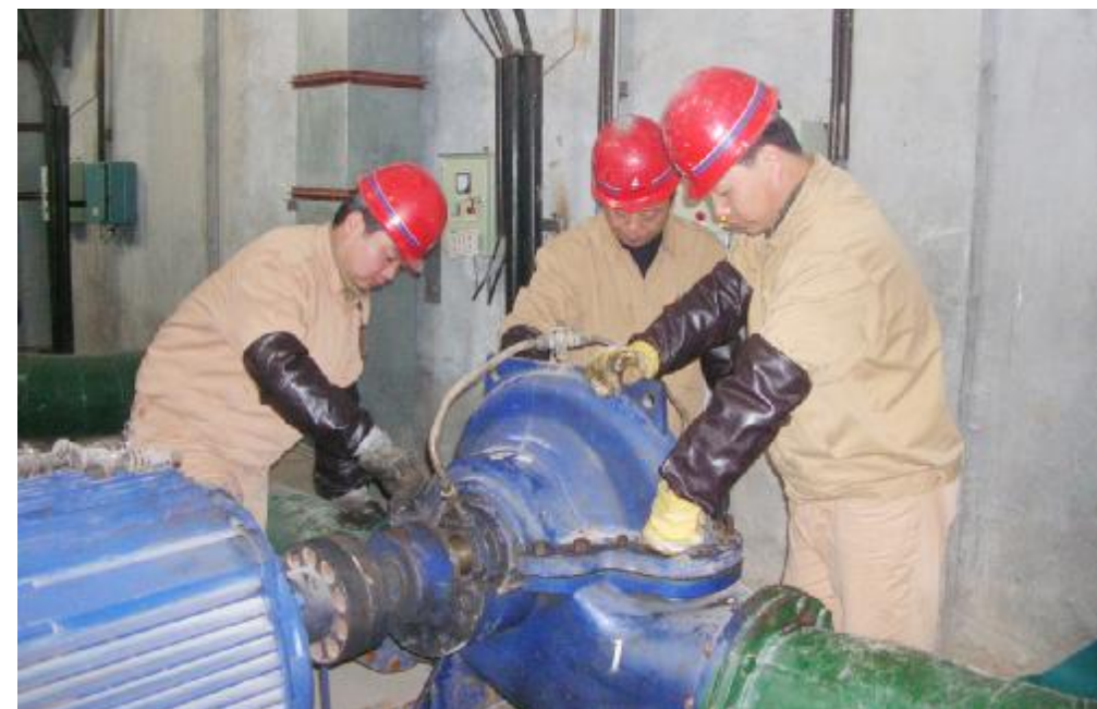
为了确保污水零排放的记录保持,近日,水电厂排水车间加大生产管理力度,合理调配生产运行方式,对关键设备进行了轮换维护、保养。图为排水车间检修人员在维护保养停运的设备。康宏伟 摄影报道
