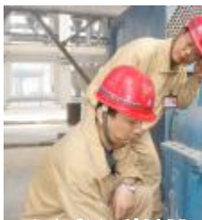
连日来,氧化铝一厂在安全周深入开展“人人查找隐患,班组处理隐患”活动。广大员工从点滴做起,认真查找隐患,有效防止了事故的发生。图为八车间员工正在仔细检查盘车过滤器真空泵。
