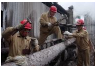
近日,为迎接中铝郑州企业建厂 50 周年,两公司职工(员工)义务劳动行动起来美化厂区环境。图为氧化铝二厂三车间员工正在清理二沉池排气管上的陈年结巴。 韩晓辉 摄影报道
